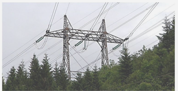
BYGGE UT: Fleire bedrifter må no vente til Statnett og dei lokale og regionale nettselskapa har fått auka kapasiteten på trossenettet.
